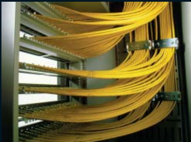
Bild 4. Kabelstrang im Steigleitungsbereich: 4-paariges 100 Ohm S/STP 600-MHz-Kabel
