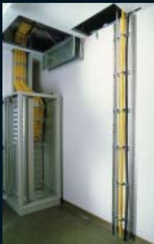
Bild 8. Strang der Sekundärverkabelung im P-Gebäude
